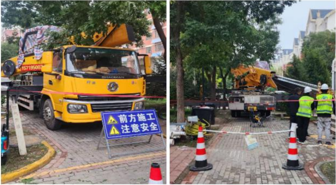
事故现场照片
